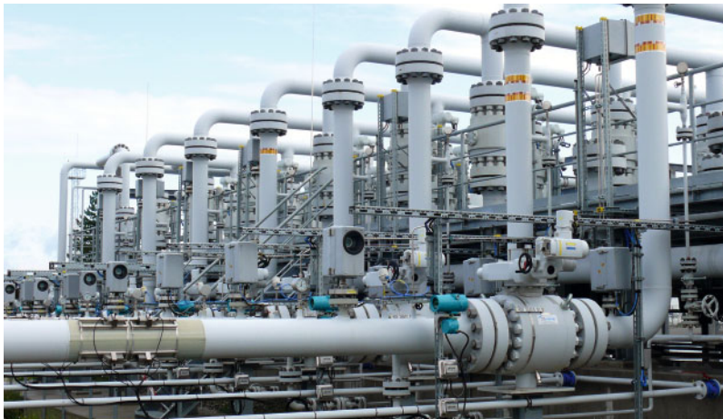
Bild 1. Der neue Betriebsplatz auf dem EWE-Erdgasspeicher Nüttermoor.
